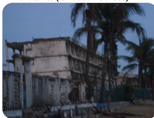
Fotografía 2. Zona hotelera afectada por huracanes (Cihuatlán-Jalisco)
